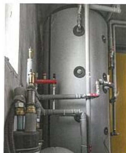
W piwnicy domu oraz w oborze w części z robotami udojowymi i schładzalnikiem mleka zainstalowano zbiorniki buforowe na ciepłą wodę.
