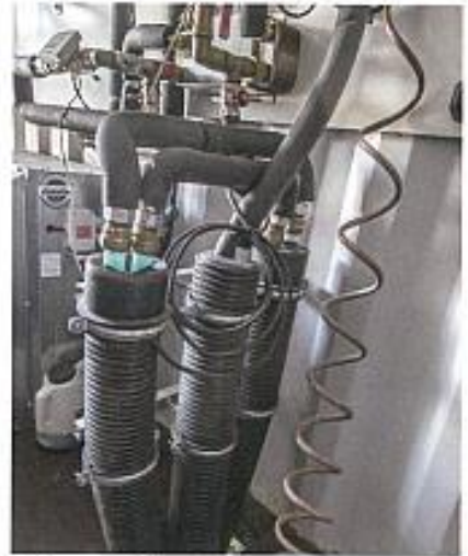
Dobrze zaizolowane przewody na wyjściu z biogazowni.
