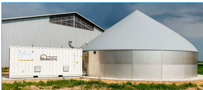
Fot. 2 | Przykład mikrobiogazowni 33 kW e produkującej do 200 MWh e /rok
