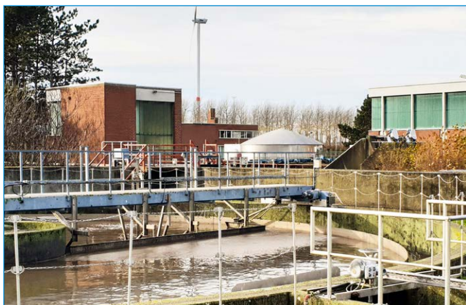
Fot. 1 | Knokke-Heist - instalacja mikrobiogazowa 22 kW e produkująca do 130 MWh e /rok
