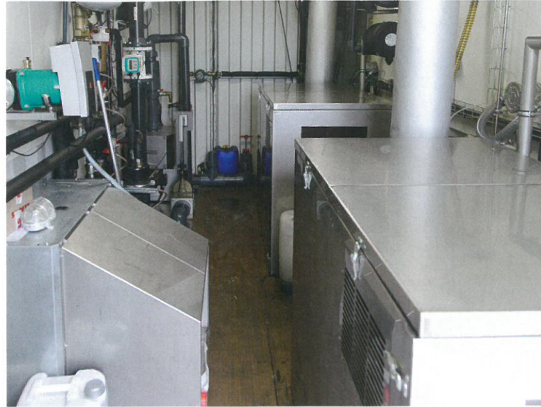
W kontenerze umieszczono dwa bloki (silnik na gaz, prądnica) po 20 kW oraz towarzyszące instalacje gazowe i cieplne.
