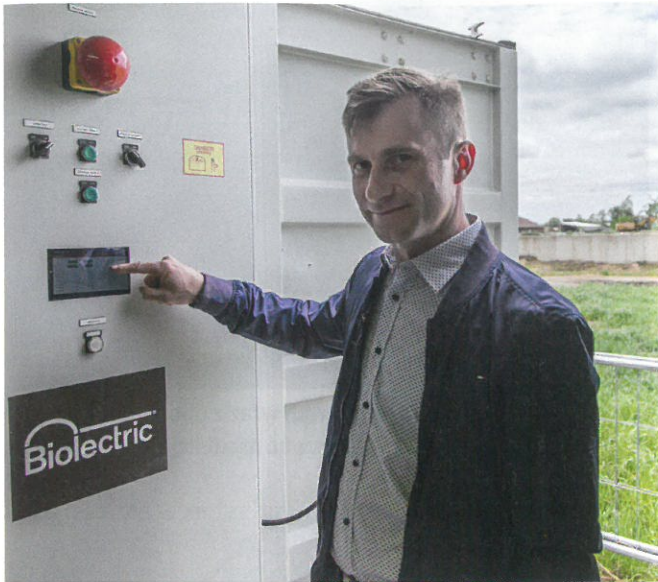
Piotr Kubiak zainwestował w biogazownię, by zmniejszyć koszty prowadzenia gospodarstwa i zagospodarować gnojowicę.
