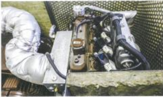
Biogazownię napędzają dwa silniki Kubota o mocy 22 i 11 kW
