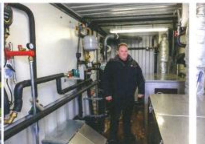
Sercem instalacji jest mały blaszany barak
