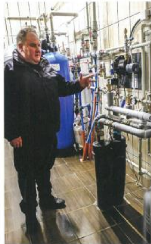
Ciepło z instalacji zostało przekierowane do obory
